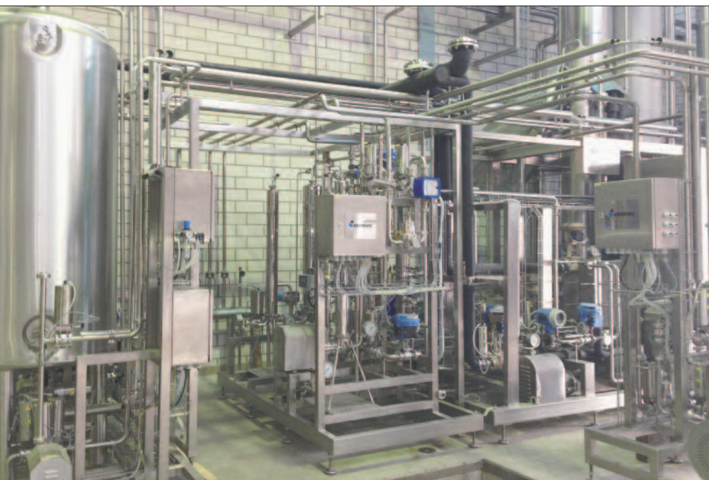
Abb. 1: Installierte Entalkoholisierungsanlage bei der Privatbrauerei Gaffel
